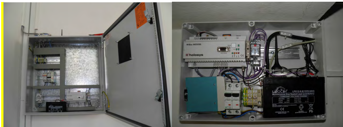
Slika 35: Centralni elektro ormar jedne od instalacija
