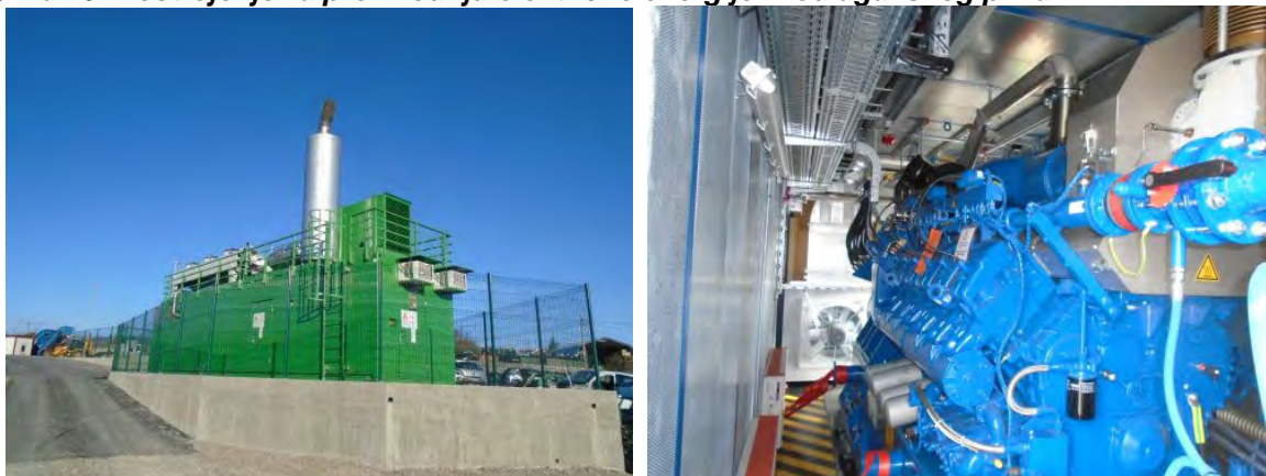
Slika 49: Postrojenje za proizvodnju električne energije iz odlagališnog plina
