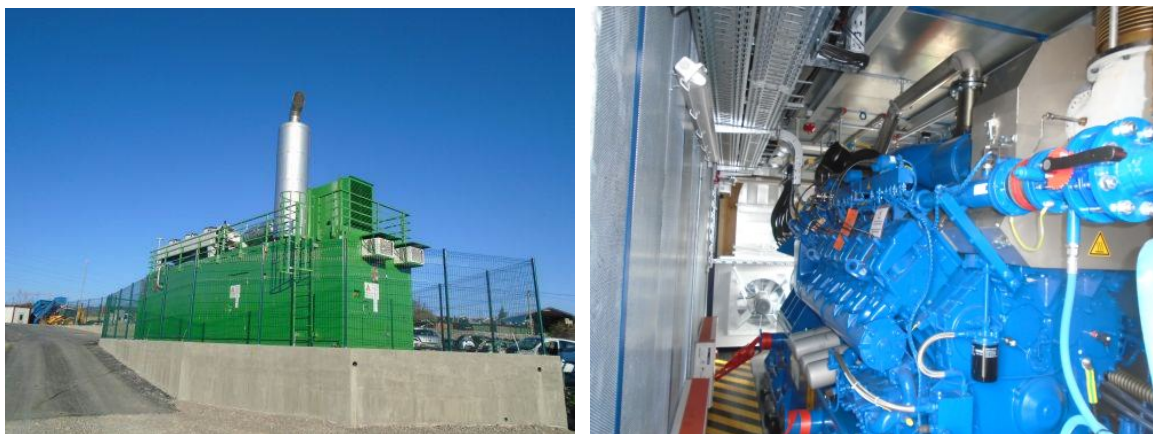
Slika 29: Postrojenje za proizvodnju električne energije iz odlagališnog plina
