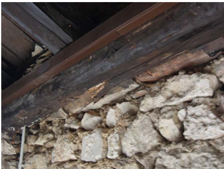
Krovište uz sjeveroistočnu kulu i njegova krovna konstrukcija oštećena vlagom
