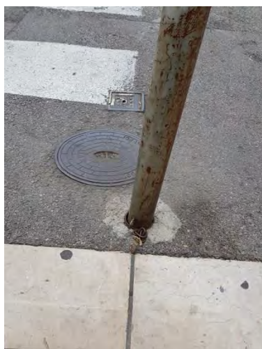
Lokot koji osigurava stupić je često nasilo uklonjen
