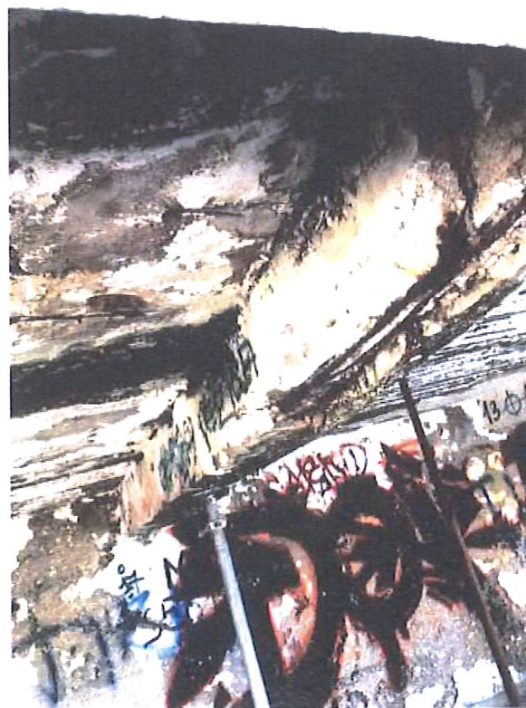
Oštećenje nosive konstrukcije i korodirana armatura (slika 4, 5 )
