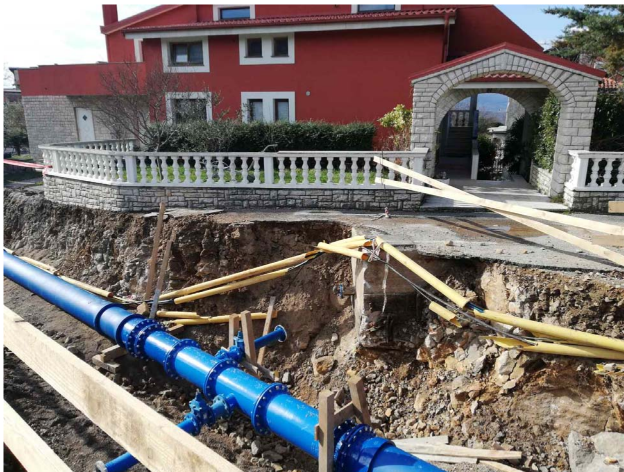
Slika 6: Radovi na komunalnoj infrastrukturi - rekonstrukcija dijela županijske ceste Ž 5055, I.faza - dionica Mladenići-Ronjgi (dio EU projekta aglomeracije Rijeka)
