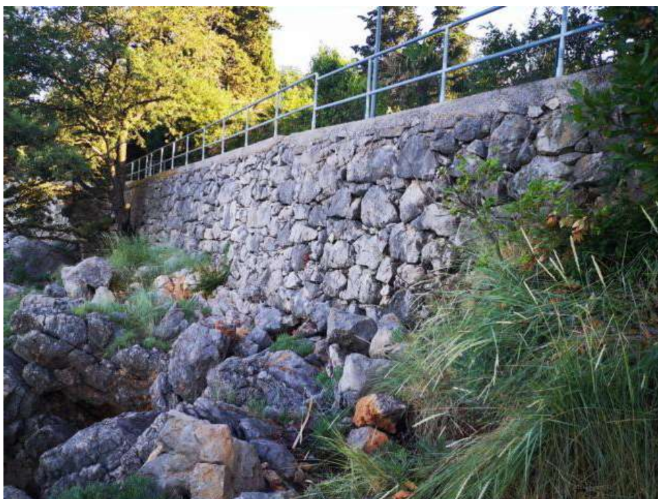
Oštećenja obloge potpornog kamenog zida (slika 8)
