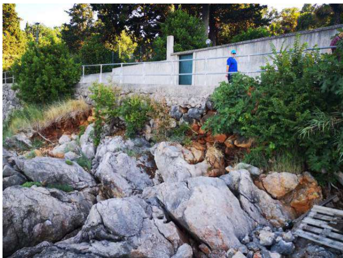
Oštećenja obloge potpornog kamenog zida (slika 6 / slika 7)
