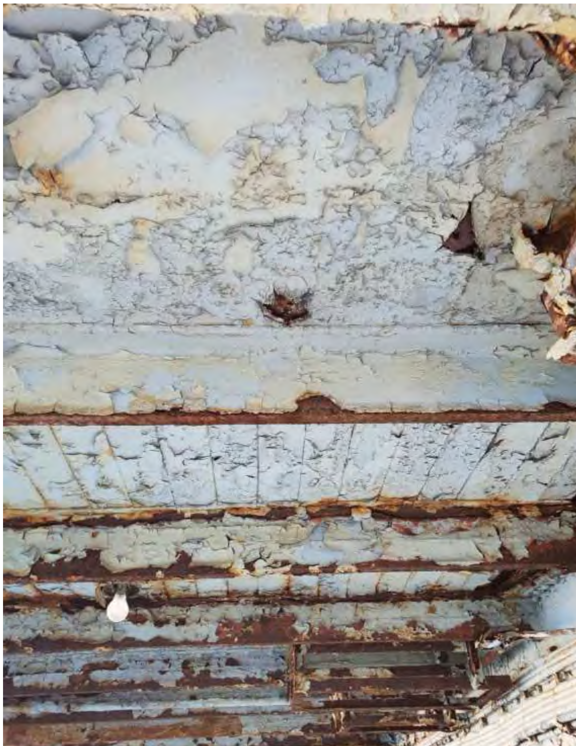
Slika 7, Oštećenje elemenata stropne konstrukcije, vanjski dio gornje palube, izvor: eLABORO d.o.o.
