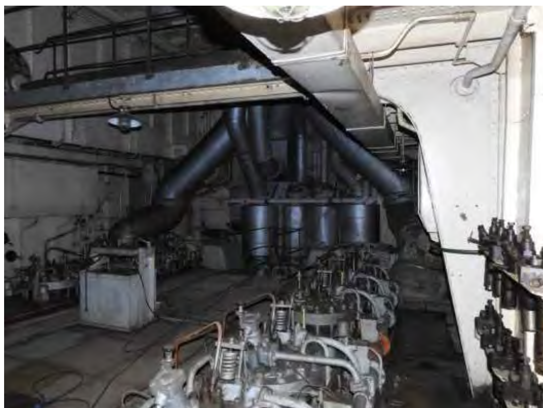
Slika 17, Pogled na strojarnicu, izvor: eLABORO d.o.o.
