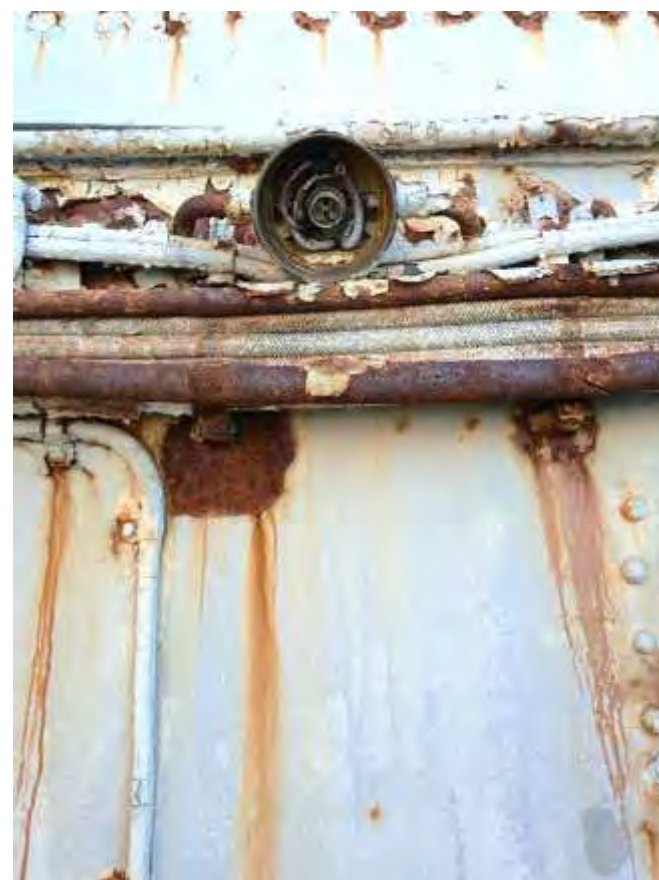
Slika 8, Zaprljanost površine produktima korozije, izvor: eLABORO d.o.o.
