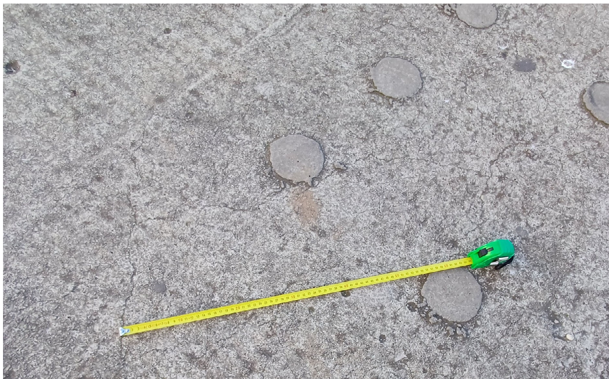
Fotografija 14. Ploča trga: položaj tangencijalne pukotine iznad stupca H8 (2)
