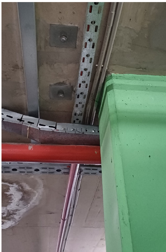
Fotografija 34. Ojačanje gornje ploče uz stup C6 na razini garaže -2; lijevo dolje vidljivo oštećenje ploče uzrokovano curenjem vode kroz ploču
