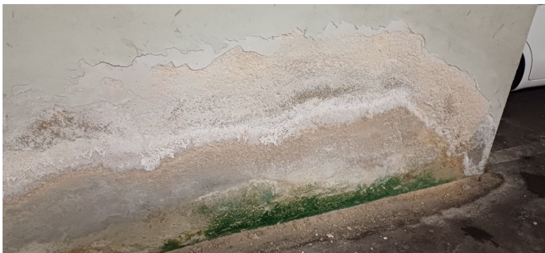
Fotografija 29. Prodor vode uz dno zida uz stup B6 na razini garaže -2; degradirana kvaliteta zida
