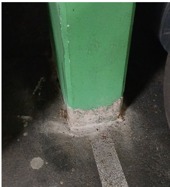
Fotografija 39. Oštećenje stupa D6 na razini garaže -2 uzrokovano prodorom vlage
