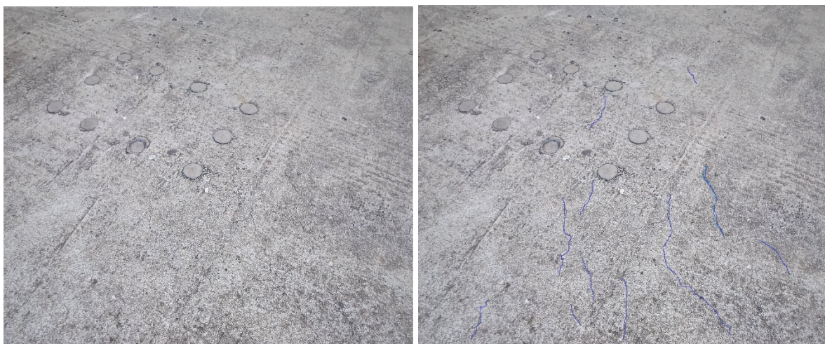
Fotografija 12. Ploča trga: pukotine oko stupa H8 (lijevo: izvorna fotografija, desno: označene radijalne pukotine)
