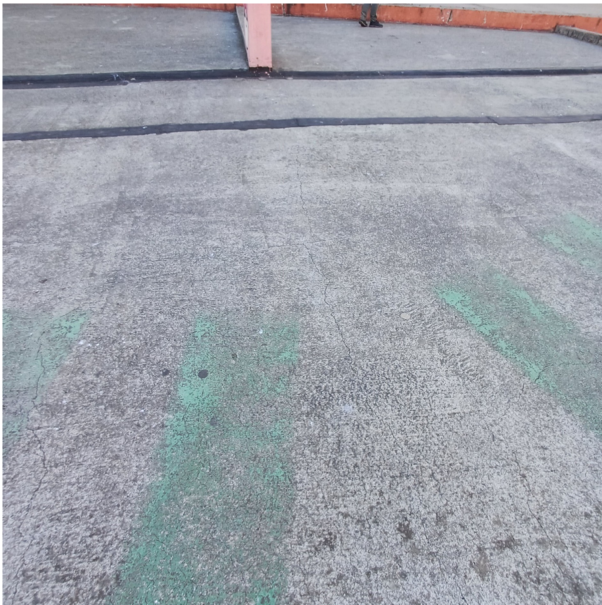
Fotografija 18. Ploča trga: uzdužne pukotine između pozicija stupova F8 i F9
