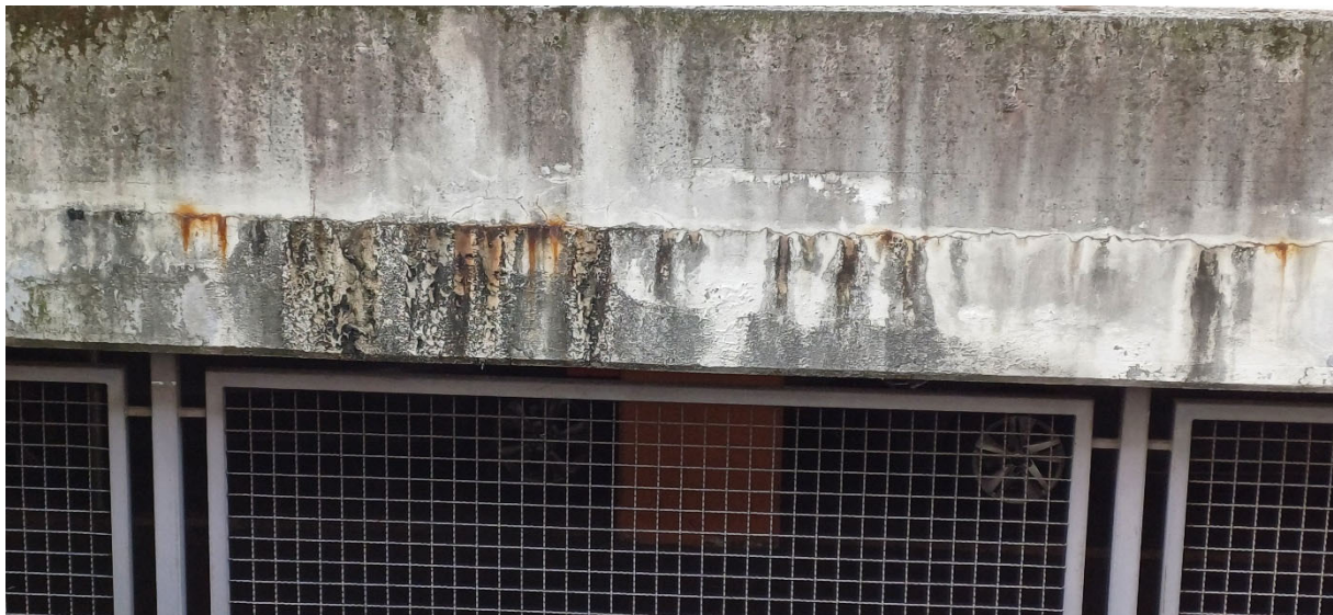
Fotografija 2. Ploča trga: oslanjanje ploče na gredu kod ulazne rampe; vidljiva oštećenja na površini (curenje vode, hrđa)
