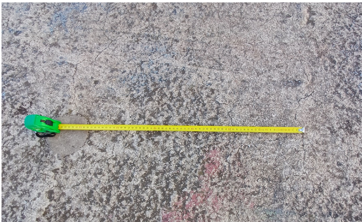
Fotografija 17. Ploča trga: položaj tangencijalne pukotine iznad stupa H9
