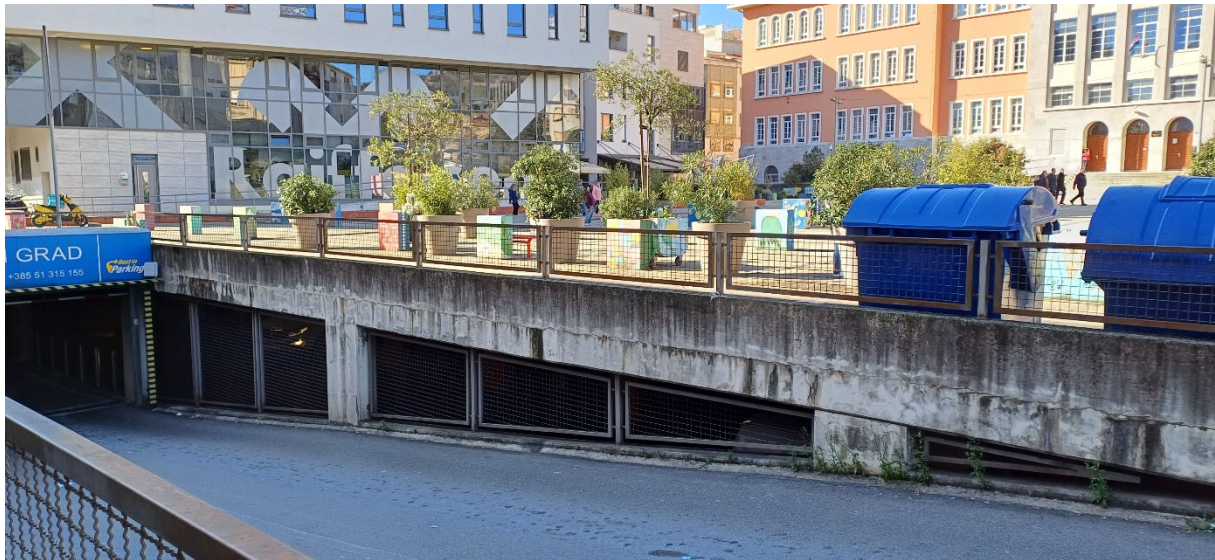
Fotografija 1. Ploča trga: oslanjanje ploče na gredu kod ulazne rampe
