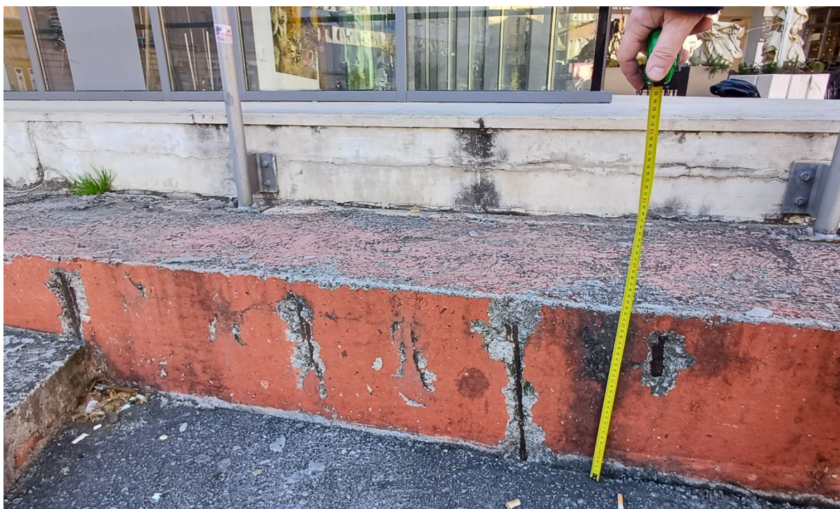
Fotografija 3. Ploča trga: kontragreda za srednjovjekovni zid – utvrđivanje visine; vidljivo propadanje grede, otpadanje zaštitnog sloja, armatura izložena atmosferskim utjecajima
