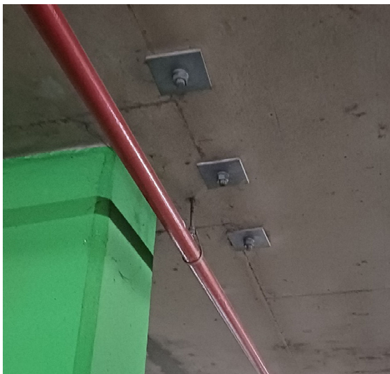
Fotografija 35. Ojačanje gornje ploče uz stup D5 na razini garaže -2;
