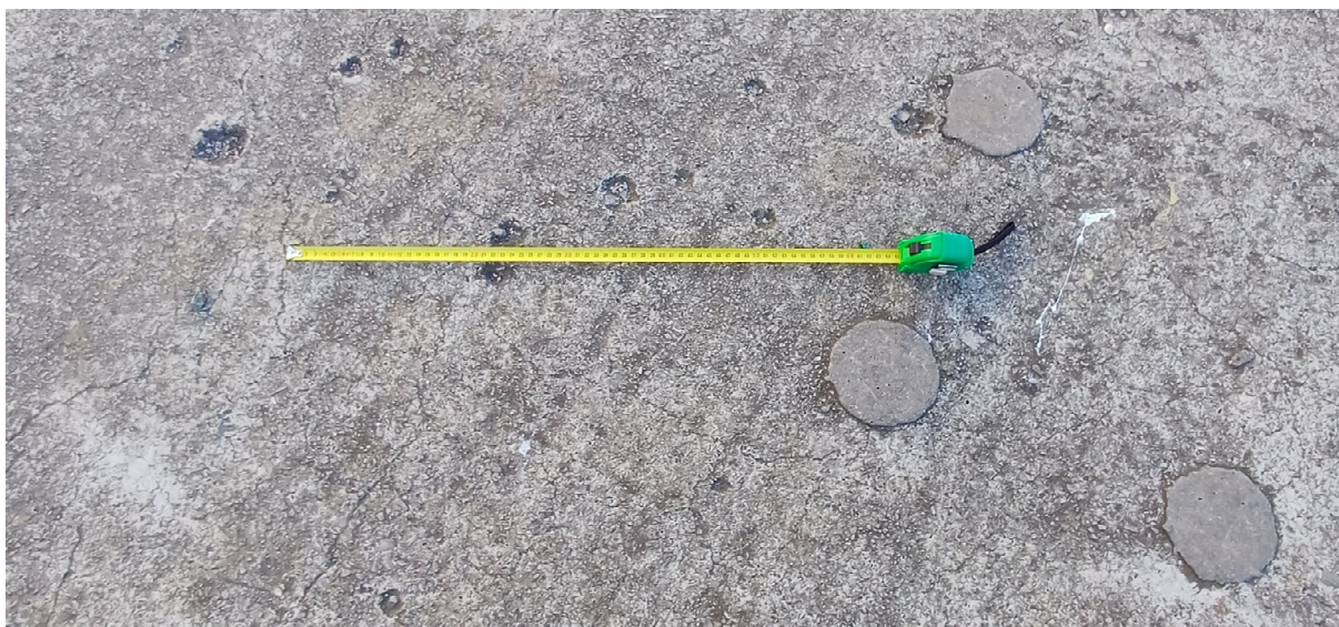
Fotografija 13. Ploča trga: položaj tangencijalne pukotine iznad stupa H8 (1)
