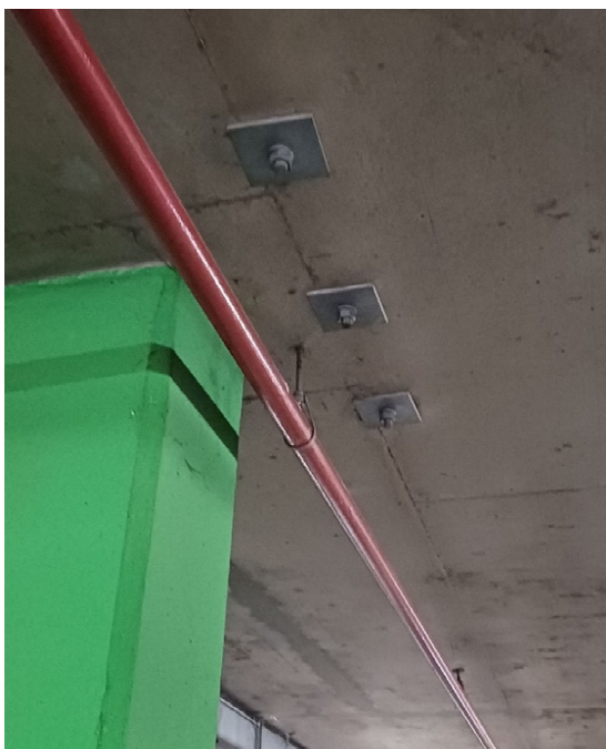
Fotografija 38. Ojačanje gornje ploče uz stup D5 na razini garaže -2
