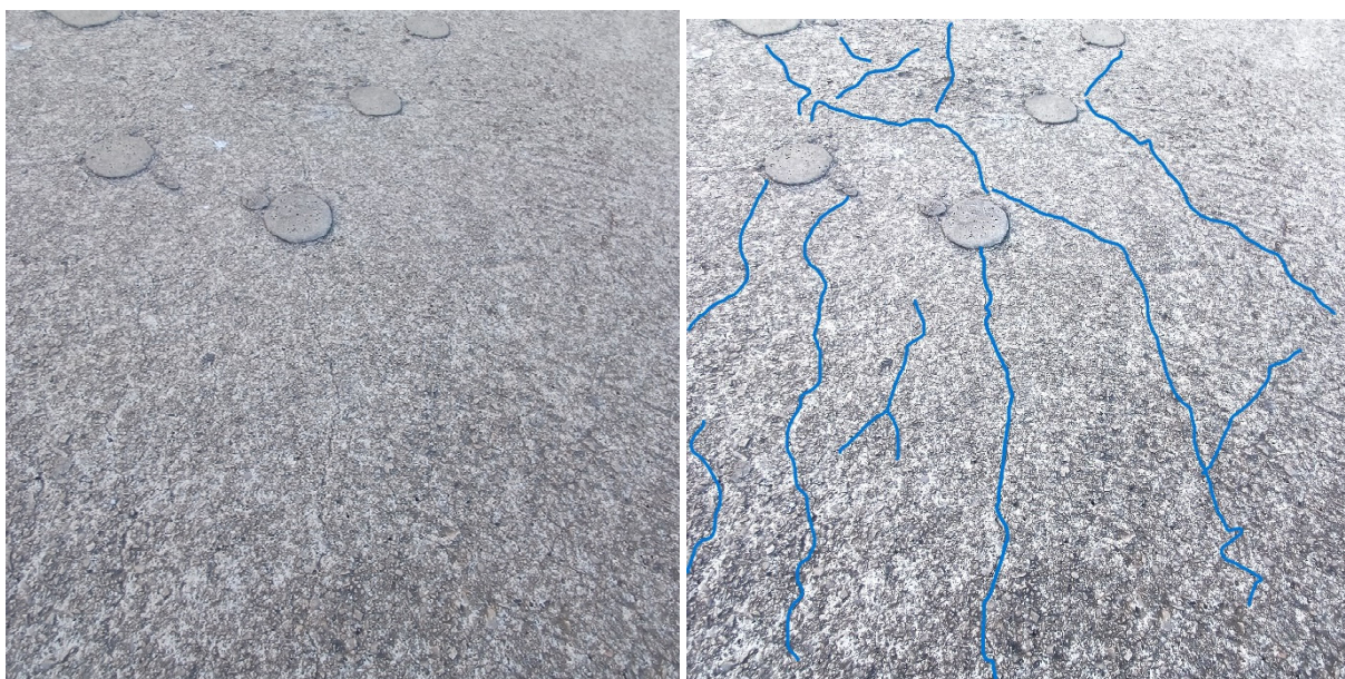
Fotografija 15. Ploča trga: pukotine oko stupa G9 (lijevo: izvorna fotografija, desno: označene radijalne pukotine)
