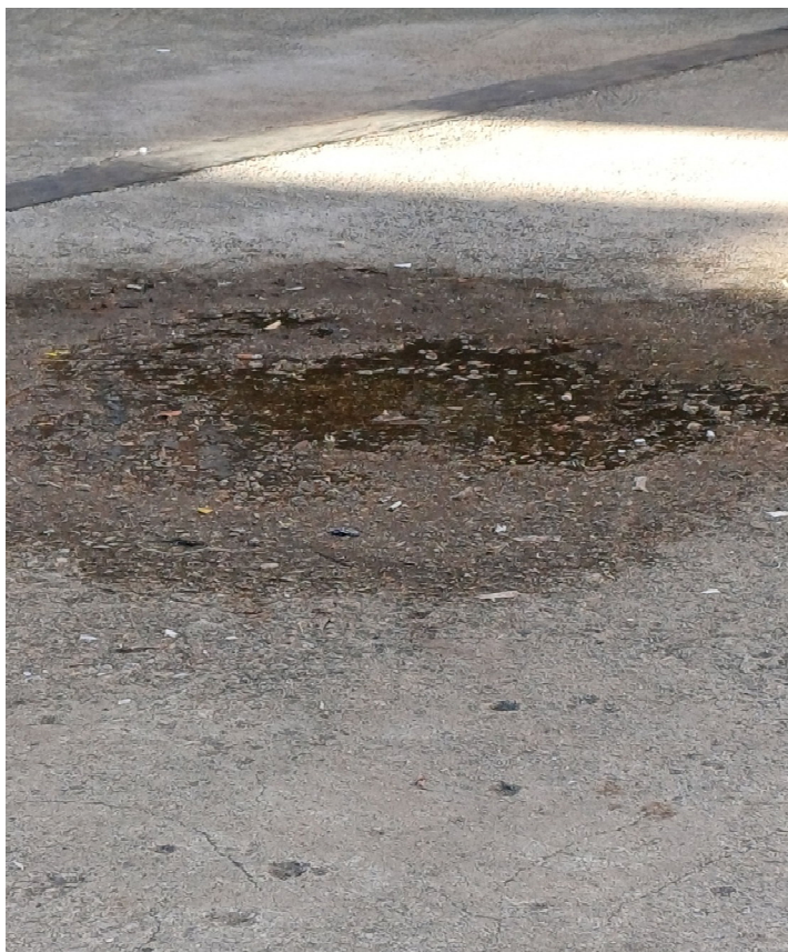
Fotografija 7. Ploča trga: zadržavanje oborinske vode na površini ploče zbog neravnina (u blizini pozicije stupa H8)
